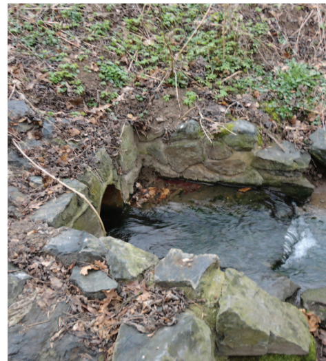
▼ Odtok z čističky odpadních vod
